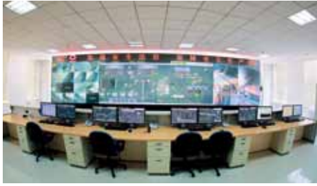
天士德宁水泥生产线中控室
